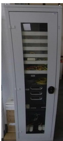
Hlavní datový rozvaděč 1
