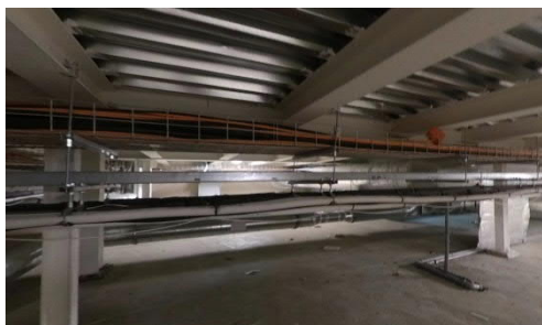
Kabelové trasy pod tiskovým sálem
