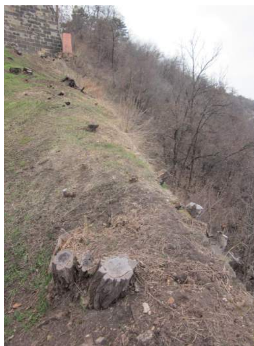
Pravá část koruny zdi 2B-zavaleno hlínou
