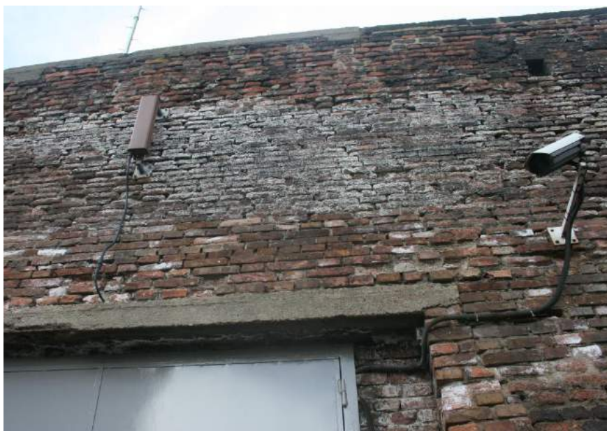
Detail nadpraží vjezdu do objektu DP na zdi 2A, kamera, vysílač GSM
