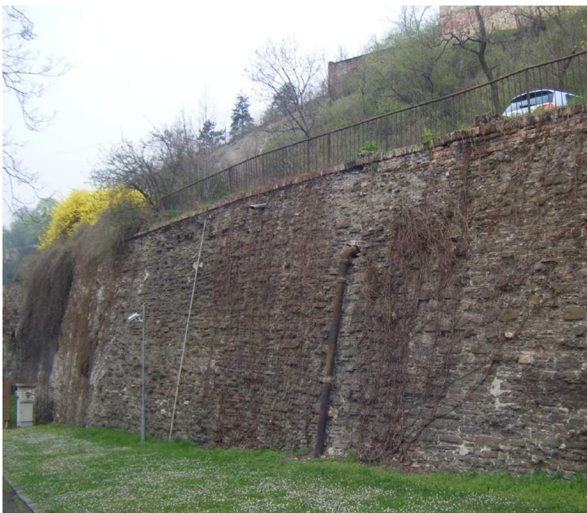
Pohled na zeď 1 u vjezdu do objektu, kamera, elektro-přívod funkční, kanalizace nefunkční.
