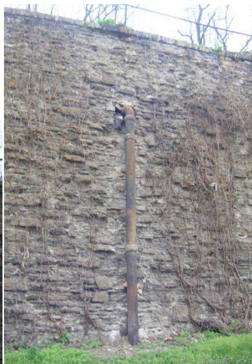
Nefunkční kanalizační svod na zdi 1
