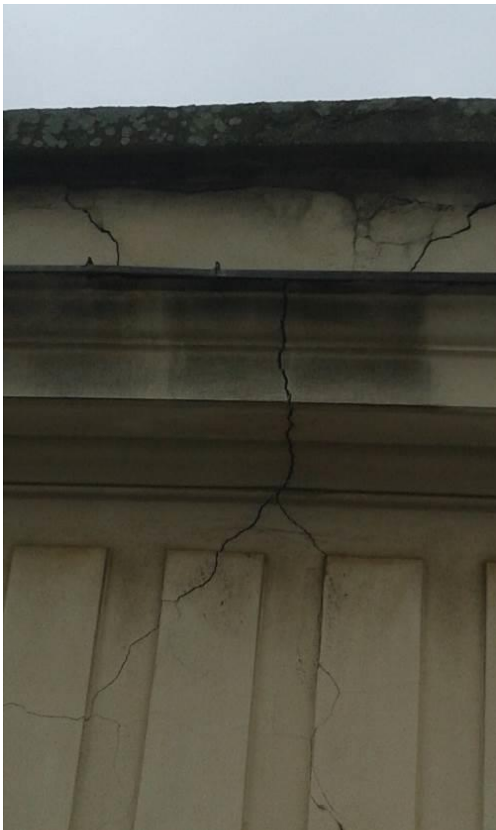
Obr. 30 – Trhliny v komínovém tělese
