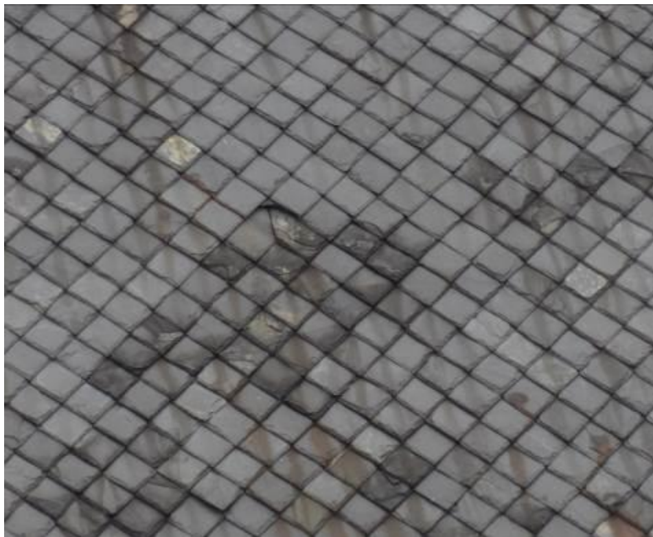
Obr. 14 – Kombinace různých poškození v ploše střech (prasklé, vypadlé kusy, nadměrná oxidace,)
