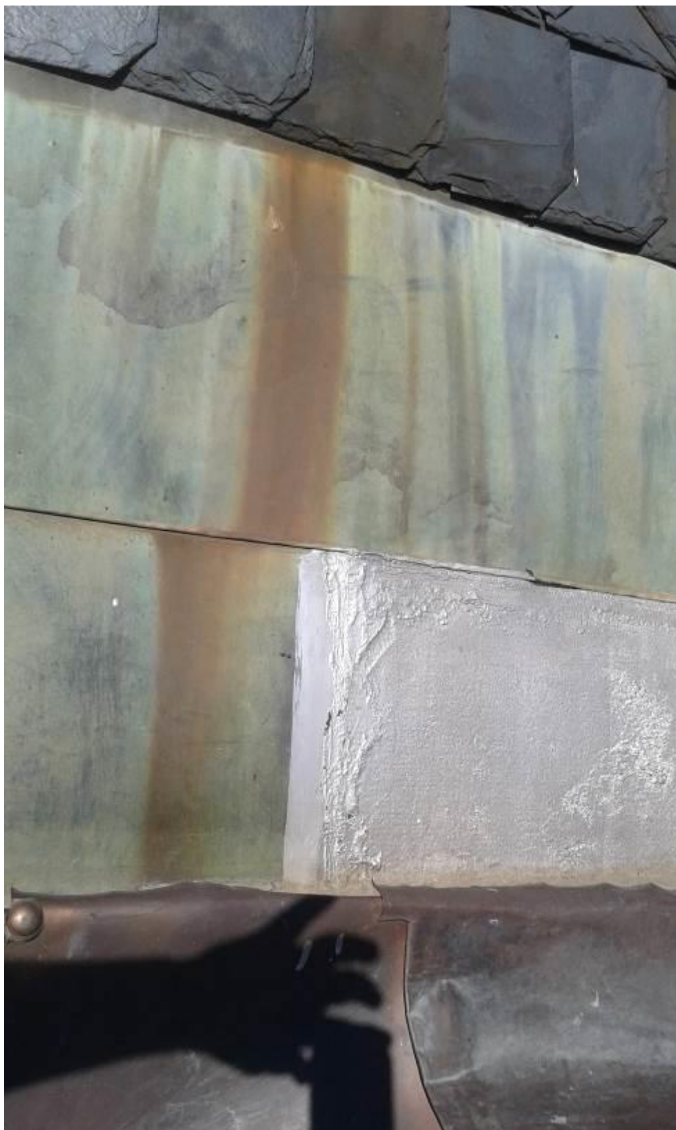
Obr. 27 – Nevhodně provedení oprava v místě okapu
