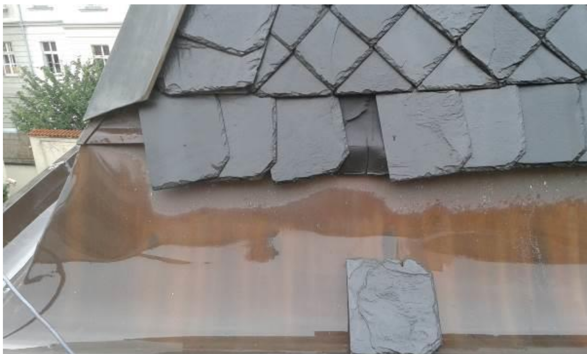
Obr. 22 - Uvolněná krytina v místě podsunutí nově provedeného žlabu – jižní výběžek (kuchyně)
