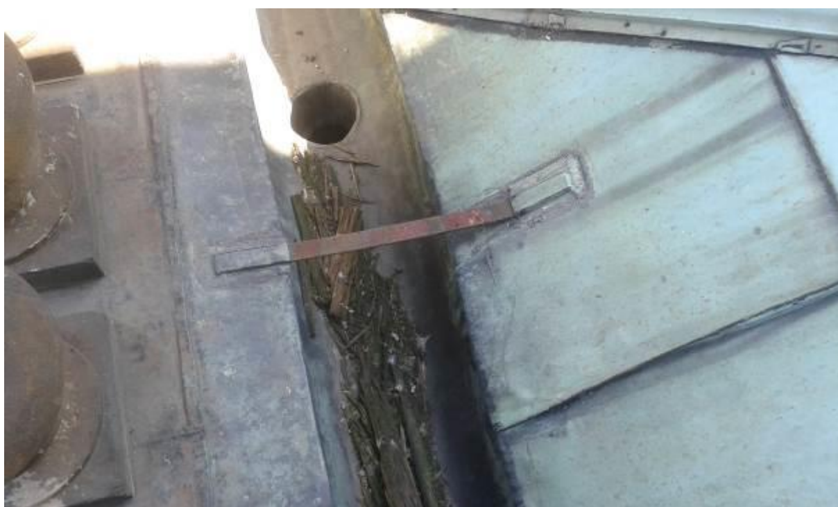
Obr. 24 – Rozpadlá revizní lávka
