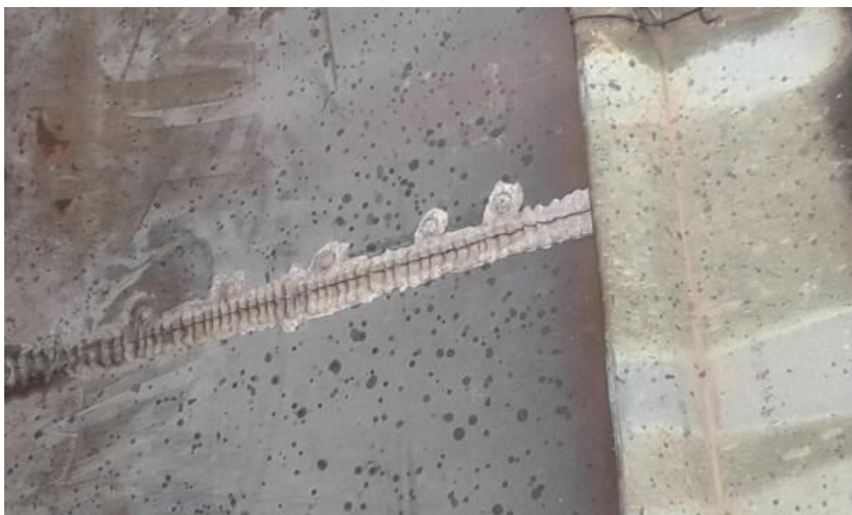
Obr. 29 – Prasklá spojka žlabu v důsledku nedostatečného počtu dilatací
