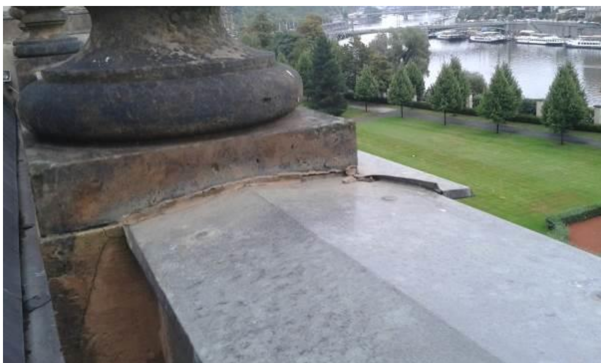
Obr. 26 – Dožilé tmelení u atiky balustrády
