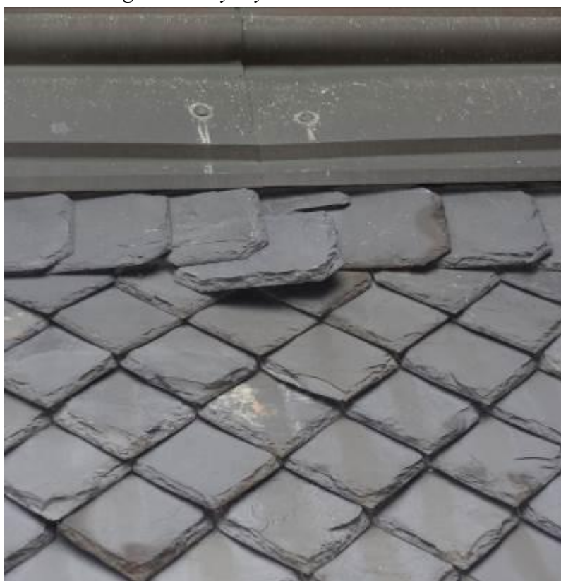
Obr. 13 – poškozená hřebenová lemovka
