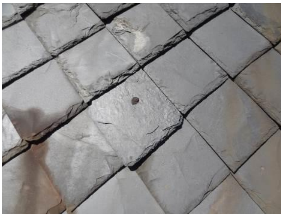
Obr. 9 – Viditelné upevnění skrz břidlice – nebezpečí zatékání
