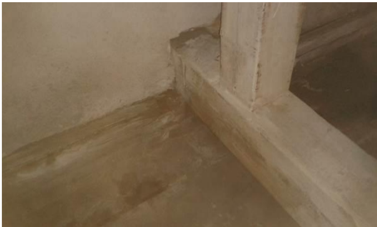
Obr. 18 – Destrukce pozednice a zhlaví vazného trámu v místě zatékání.
