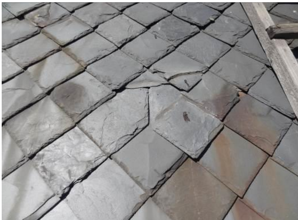
Obr. 4 – prasklé kusy břidlice v ploše, zdroj zatékání
