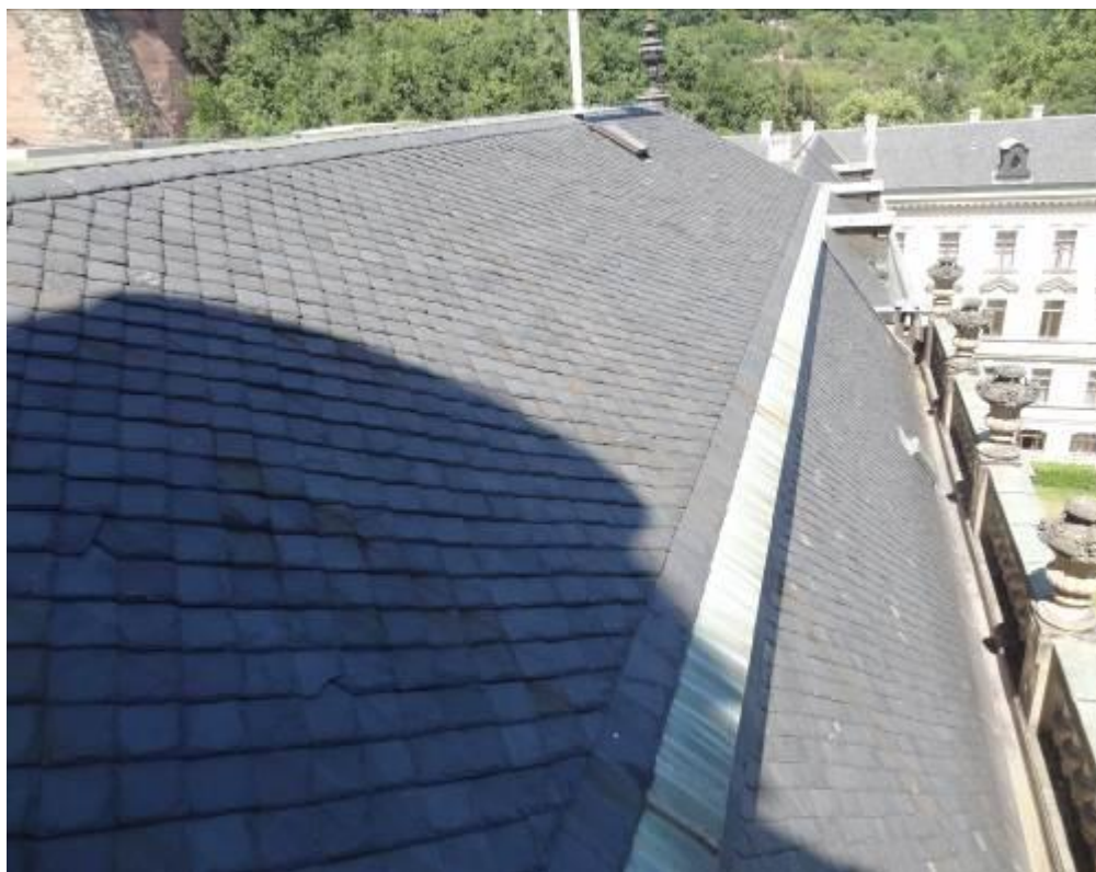
Obr. 10 – Vypadlé kusy v ploše střechy
