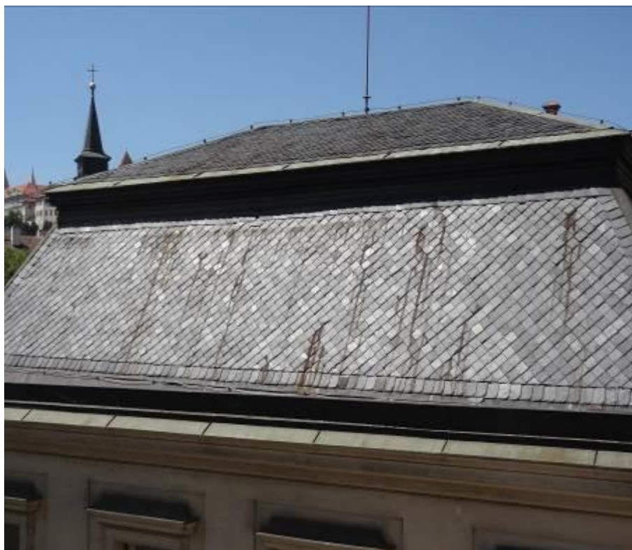
Obr. 12 – Degradace krytiny vlivem oxidů železa v kameni
