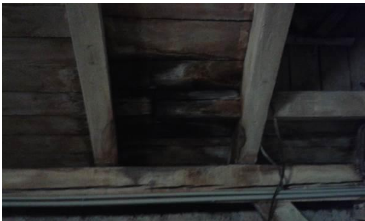
Obr. 17 – Destrukce části krovu v místě zatékání.
