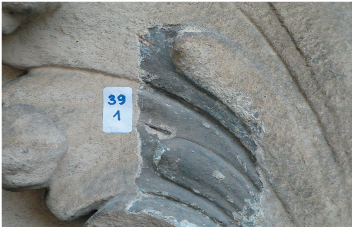
sonda 1 - prefabrikované součásti štukové výzdoby s kovovým armováním. Pod vrstvou nátěrů značně zaslepené modelace
