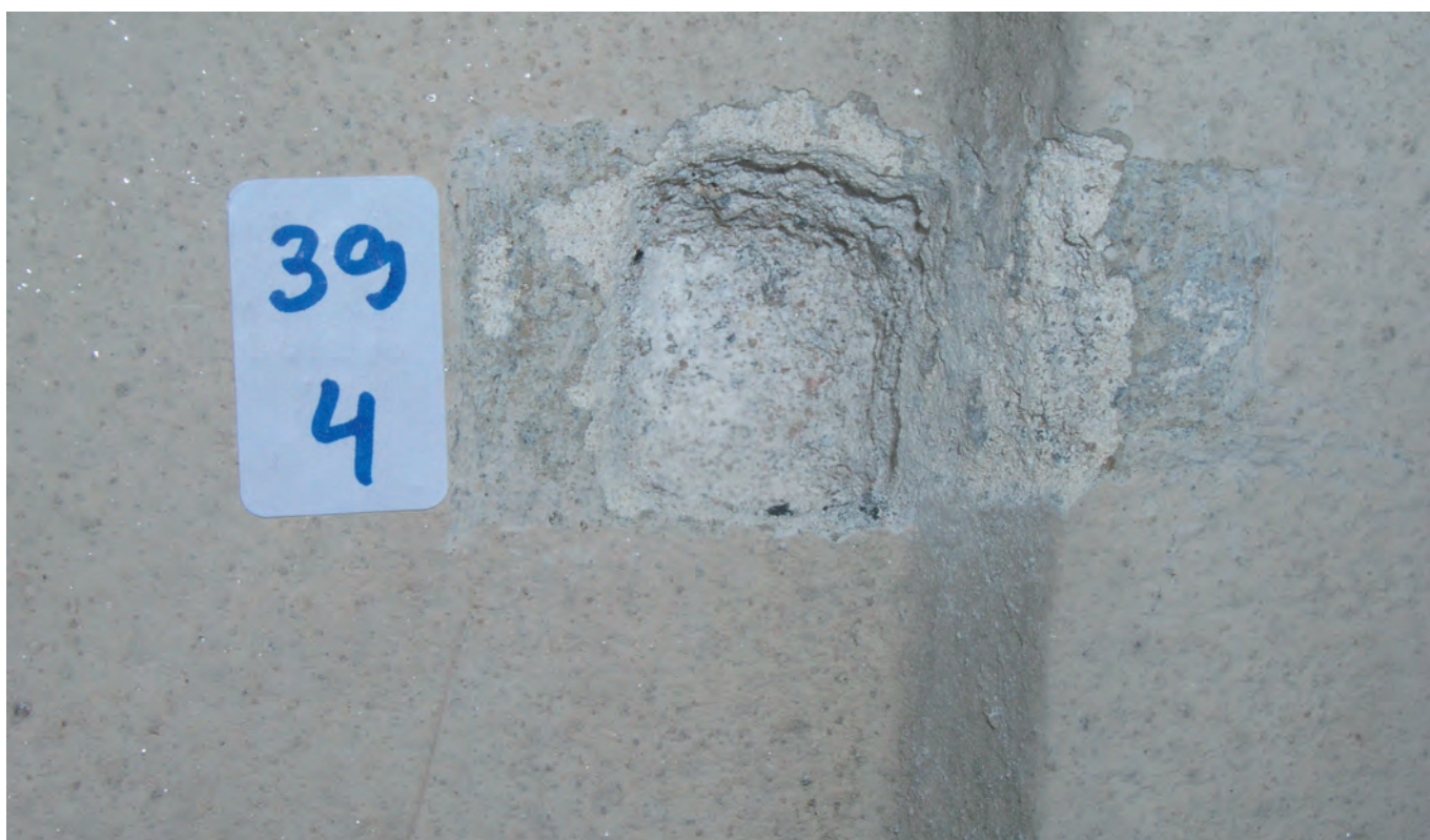
sonda 4 - oblast novějších oprav
