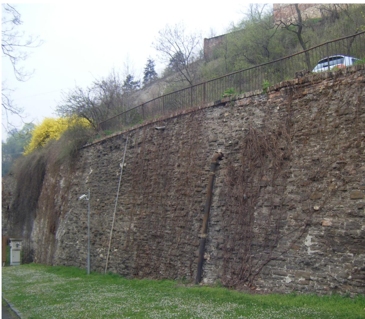
Pohled na zeď 1 u vjezdu do objektu, kamera, elektro-přívod funkční, kanalizace nefunkční.
