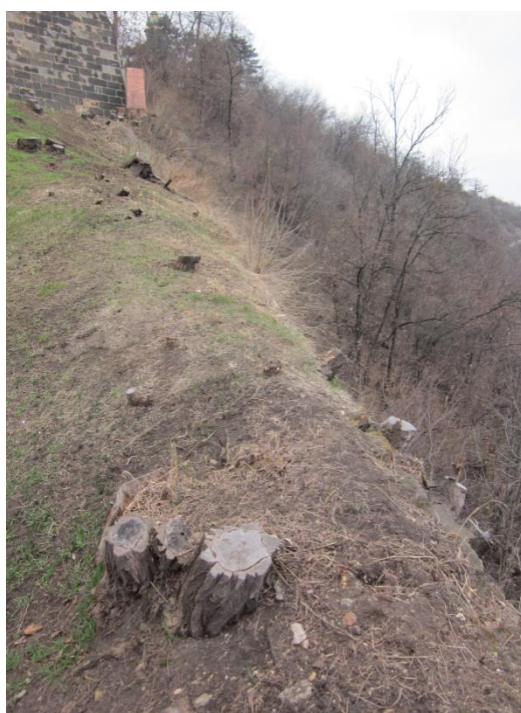
Pravá část koruny zdi 2B-zavaleno hlínou
