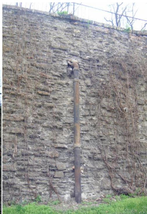
Nefunkční kanalizační svod na zdi 1
