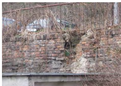
Zdivo nad garážemi zdi 1
