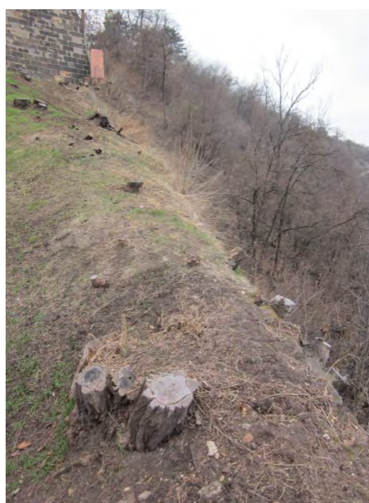
Pravá část koruny zdi 2B-zavaleno hlínou
