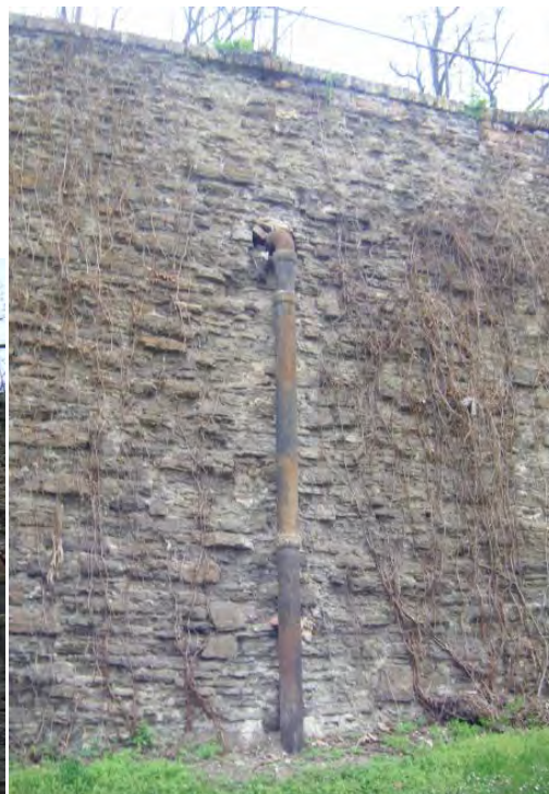
Nefunkční kanalizační svod na zdi 1
