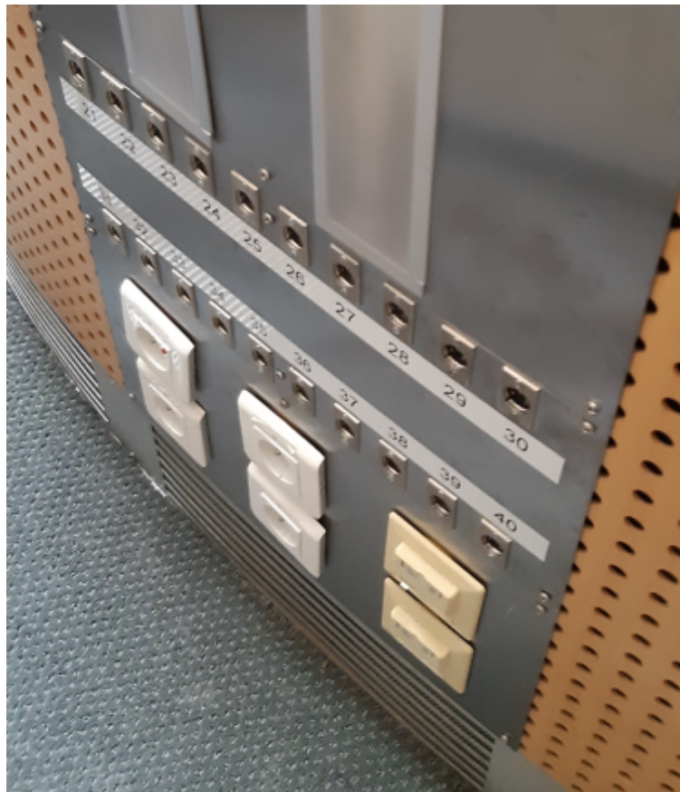
pohled na konektorové pole a zásuvky
